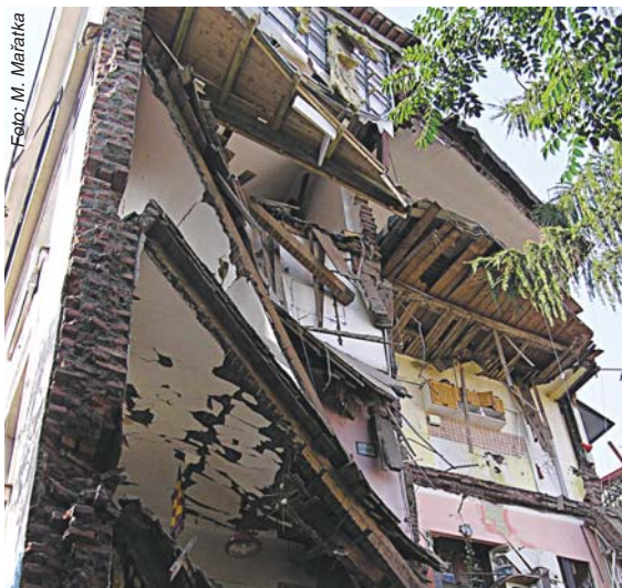
Majitel nedávno zříceného domu v blízkosti Balabenky již objekt staticky zajistil a odstranil sut. Podle rozhodnutí statika budova nemusí být odstraněna. Vlastník by nyní měl předložit projekt na opravu stavby.
