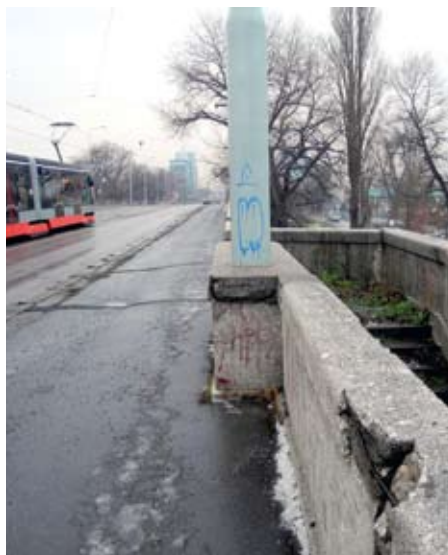
Libeňský most je v současnosti ve velmi špatném stavu. Město na opravu nemá peníze
