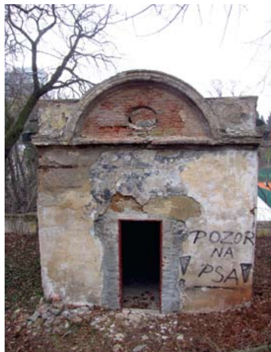
Objekt je v současnosti ve velmi neutěšeném stavu
