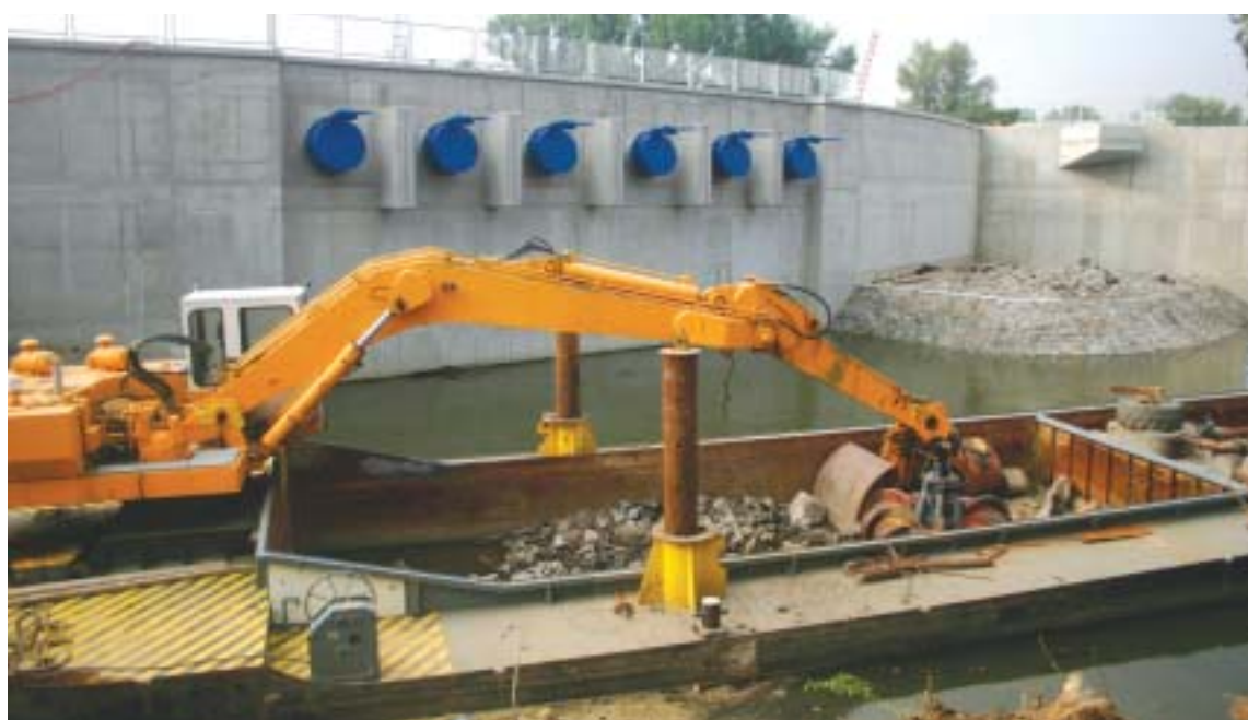
Obří přečerpávací stanice má zamezit vtoku velké vody z Vltavy do koryta Rokytky. Konečnou podobu získala stavba v únoru 2005.
